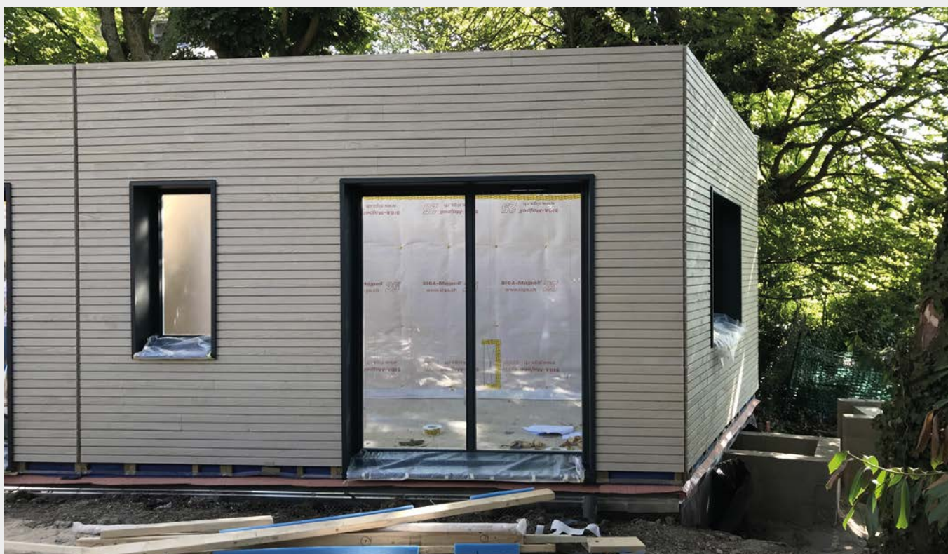
un chantier à Sèvres. Pare-pluie, pare-vapeur, bardage et menuiseries aluminium sont posées en atelier.
